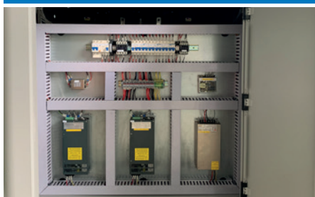
Dettaglio impianto elettrico
