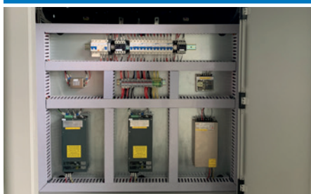
Dettaglio impianto elettrico
